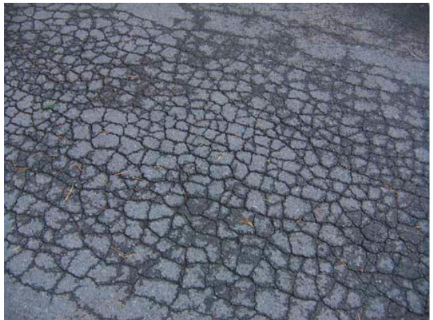
図2 アスファルト道路におけるワニ状の亀裂作用
